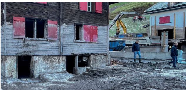
Gebäudeschaden bei Murgang Wagenrunse, Schwanden, GL.
